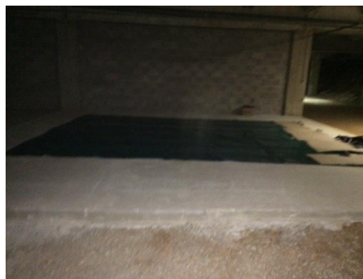
Le récupérateur souple installé en sous-sol du lycée
